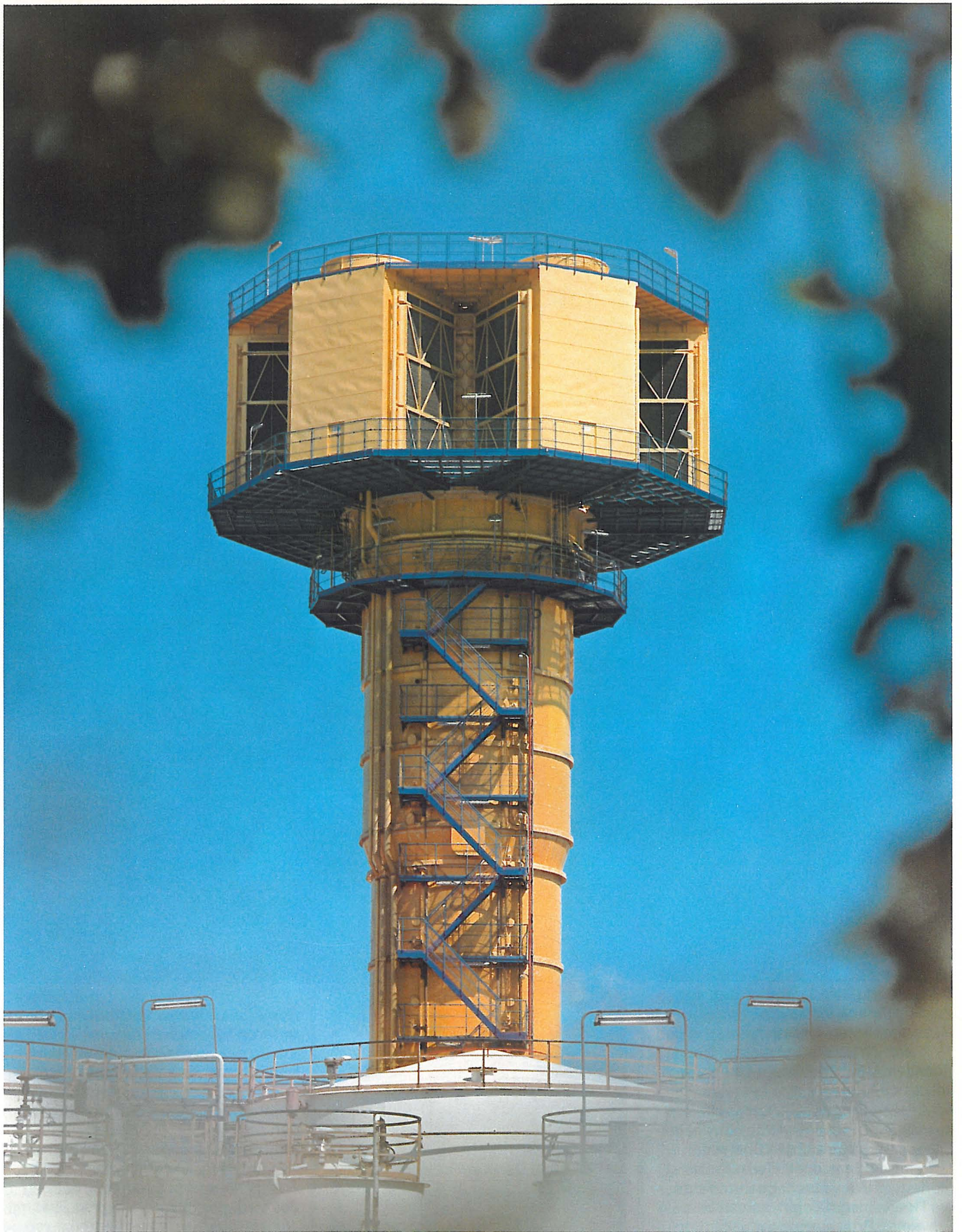
Luftkühler auf einer Destillationskolonne im Werk der BASF Antwerpen N. V.
