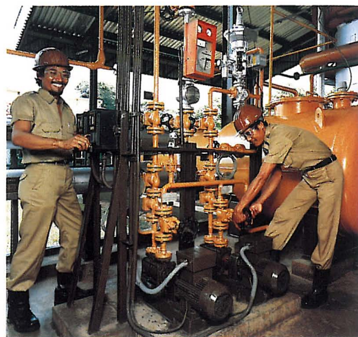
Mit Hilfe moderner Anlagen werden Lösemittel zurückgewonnen und dem Produktionsprozeß wieder zugeführt. Dies spart wertvolle Rohstoffe und entlastet die Umwelt. Das Bild zeigt eine solche Anlage bei der BASF Indonesia in Jakarta, die bei der Beschichtung von Tonbändern eingesetzt wird.
