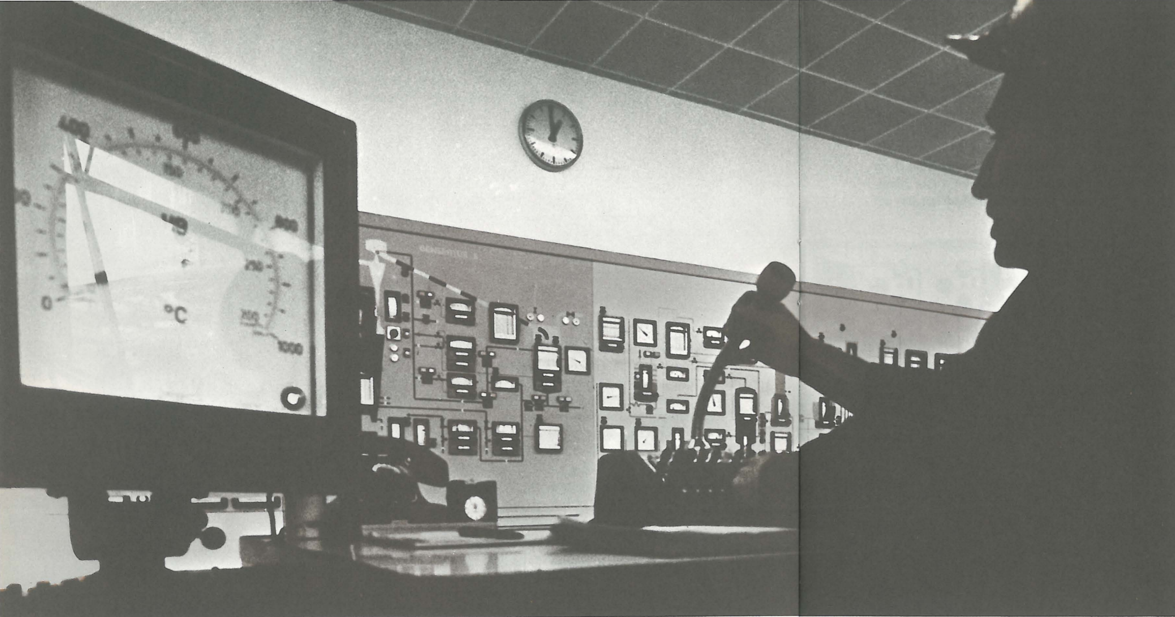
Meß- und Regelwarte einer Ölsplatanlage zur Olefinerzeugung
