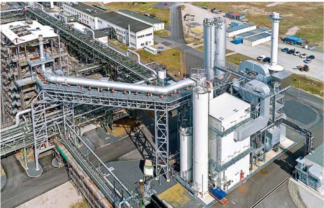
Blick auf die Rückstandsverbrennungs-Anlage mit der neuen Rauchgasreinigung im Vordergrund.
