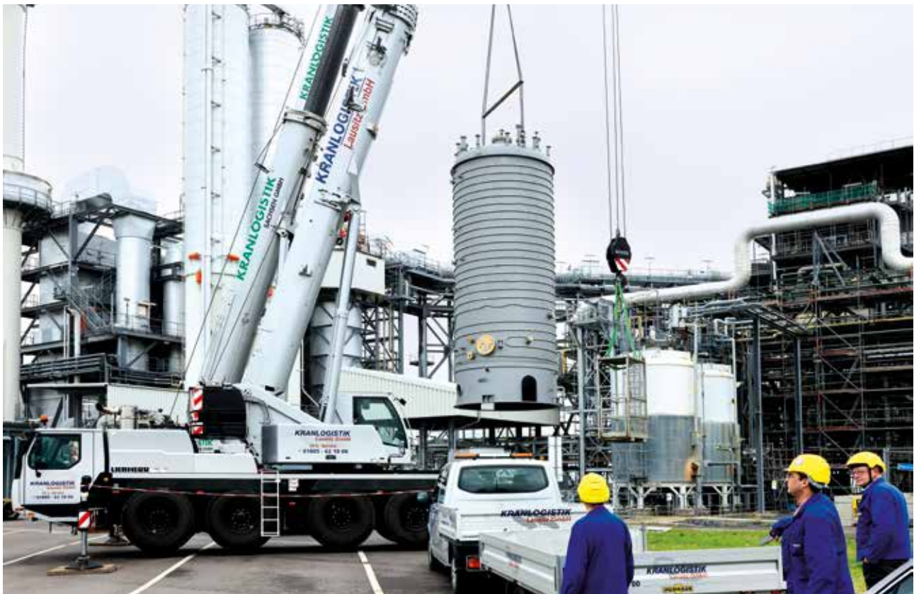
Montage des neuen Rückstandsbehälters B4103, der künftig eine besondere Rolle im Projekt Organic Waste Reduction (OWR) spielen wird.
