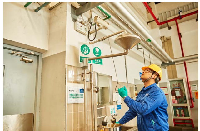
每套生產裝置和實驗室均有緊急沖淋設施。
