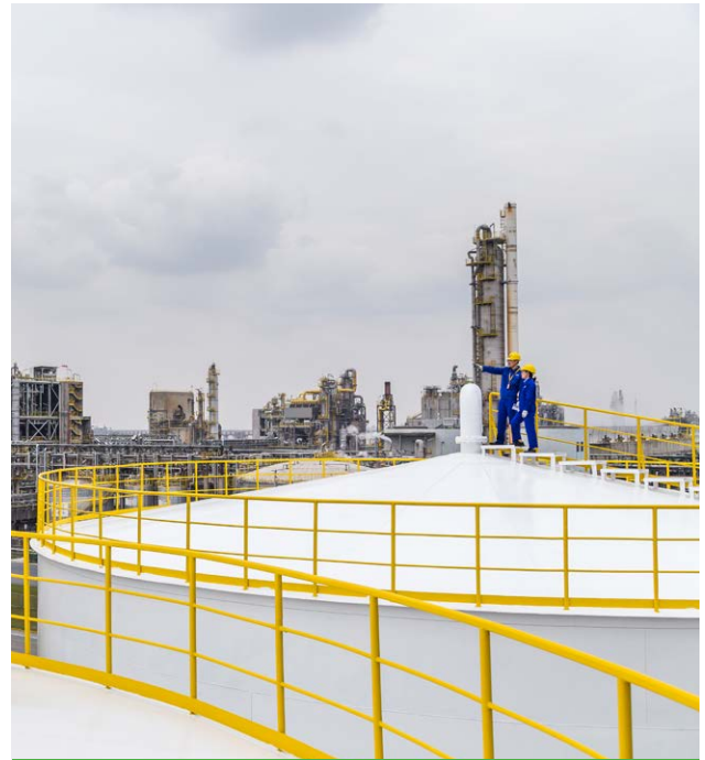
在上海漕涇基地，兩位巡查員在對消防水槽進行例行性檢查，確保所有緊急應變設施都處於最佳運作狀態。
