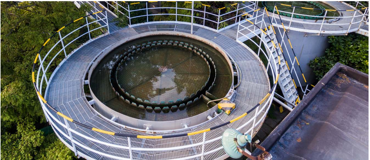
位於巴斯夫上海浦東科技創新園的水槽將來自黃浦江的水進行淨化和過濾，用於生產、冷卻和消防。
