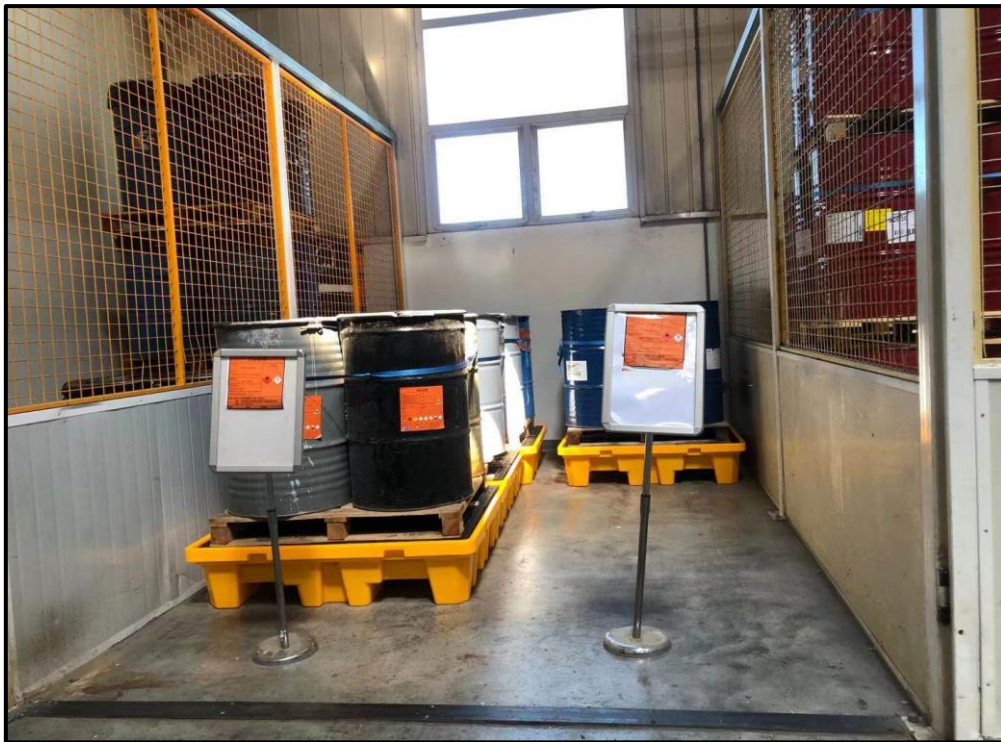
图 2.4-4 危险废物暂存间内部图
