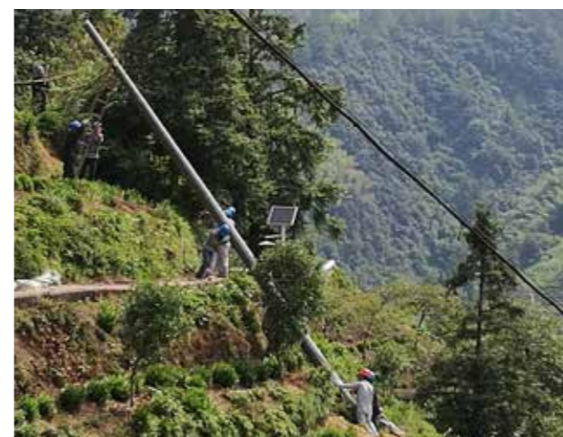
聚氨酯复合材料制成的电线杆确保山区的电力供应。
