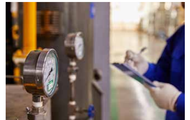
检查生产装置内的压力
