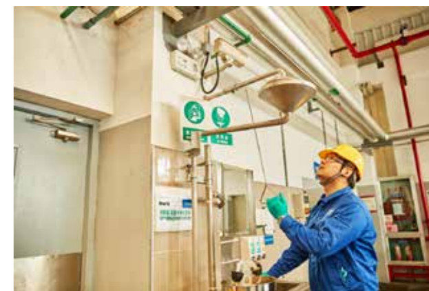
每套生产装置和实验室均有紧急冲淋设施。
