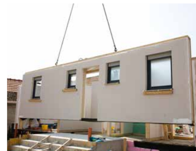
装配式建筑可提升现场施工效率，并能更好地管控建筑部件的质量。
