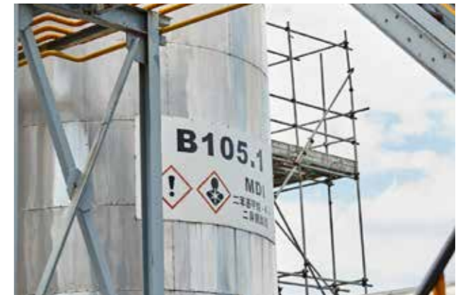
MDI储罐上的安全标识
