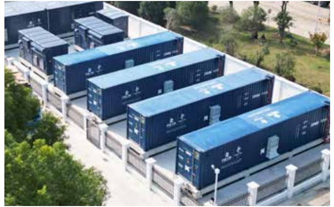
2022年，巴斯夫在大中华区的首个企业储能电站在上海科技创新园投入运营。
