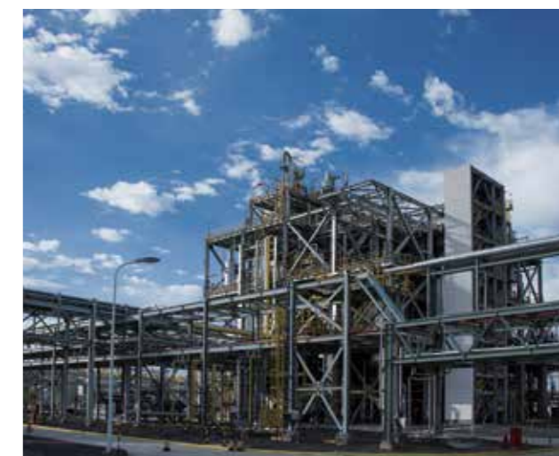
在库尔勒基地新建的聚四氢呋喃装置。
