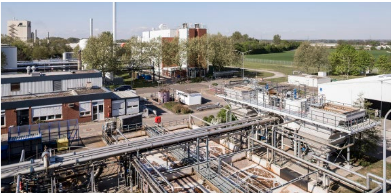
Kläranlage des Standortes
