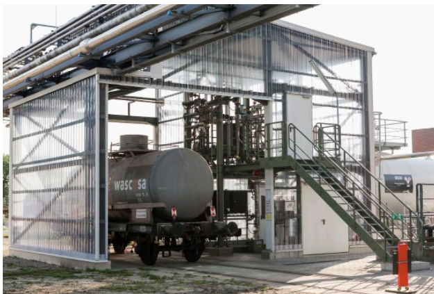
Überdachte Entladestelle für Bahnkesselwagen
