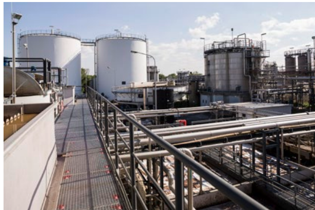
Kläranlage des Standortes
