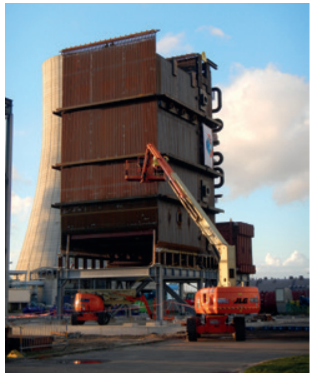
Om beter te kunnen anticiperen op de fluctuerende prijzen op de energiemarkt bouwt BASF Antwerpen aan een nieuwe stoomketel.
