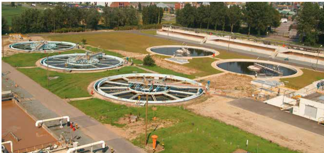
Bij de ingebruikname van onze waterzuiveringsinstallatie in 1980 was BASF Antwerpen een van de eerste bedrijven in het havengebied dat afvalwater biologisch ging zuiveren.
